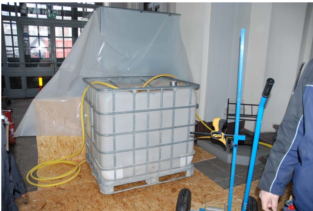
Tank för uppsamling av slamvatten.
