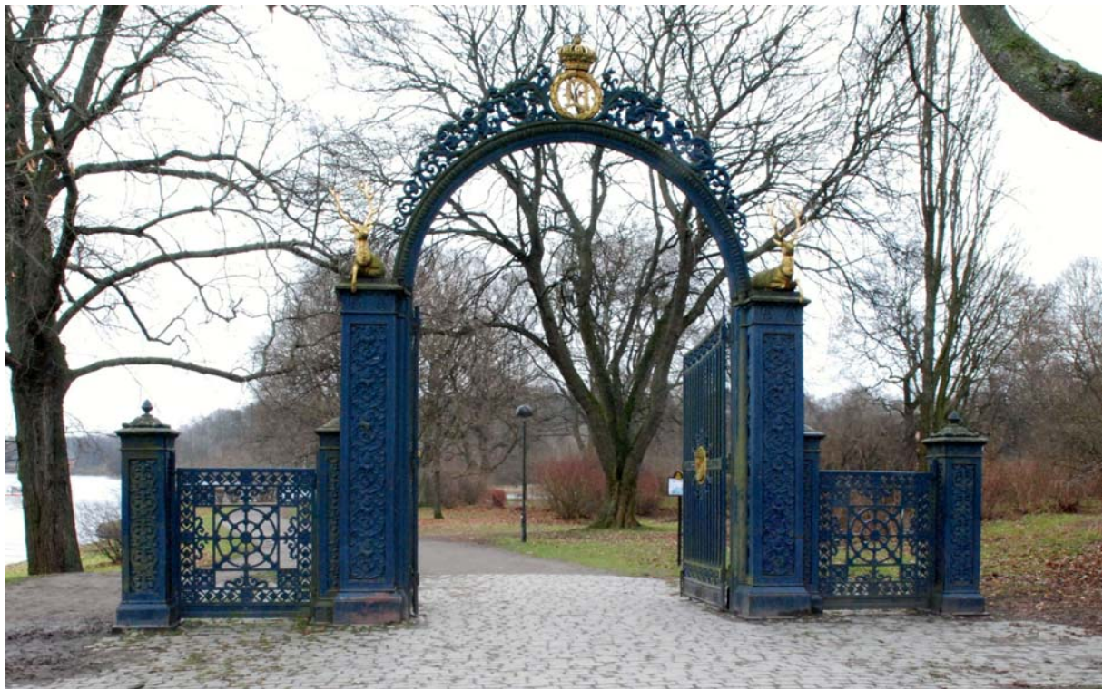
Porten var före renovering målad med plastfärg och i ett uselt skick.
