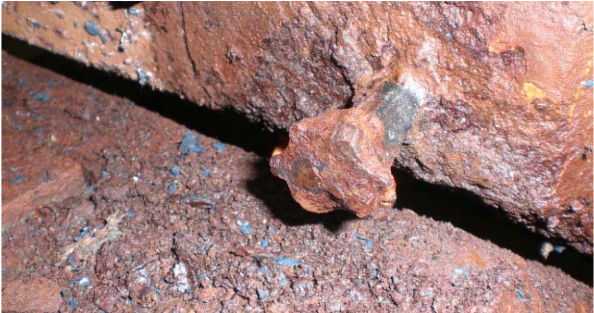
Insidan var inte alls rostskyddsbehandlad på vissa stolpar. Rester av bult. Fästörat är helt borta.
