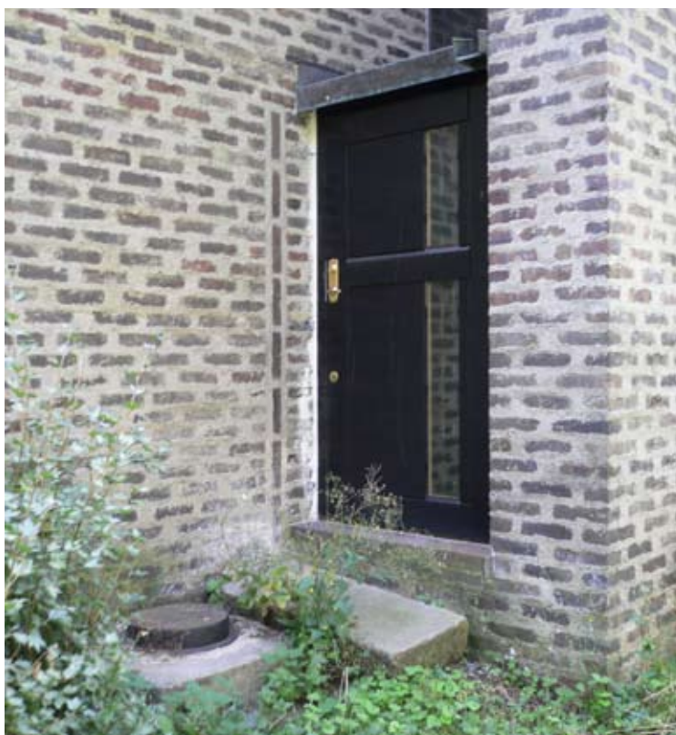
Sättningspro- blemen gör att utrymnings- trapporna blir svår använda.
