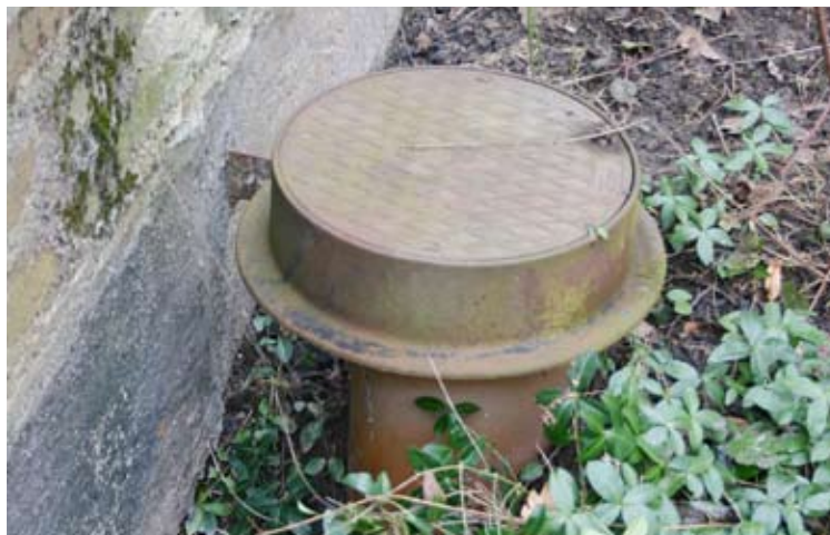
Sättningsproblemen gör att brunnar m.m. sticker upp ur marken.
