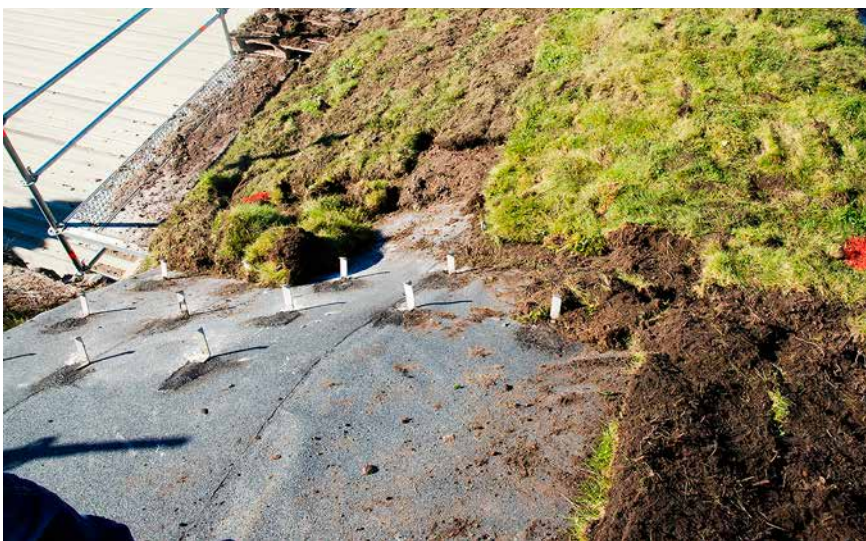
Läggning av grästorv på krönet. Först ett lager med gräset neråt, sedan ett med gräset uppåt.
