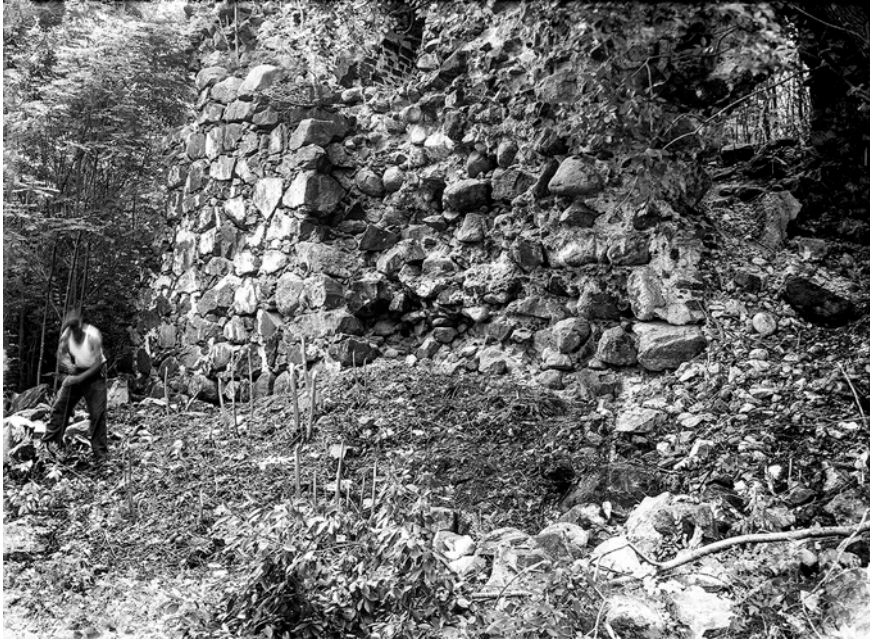
Detta är ett foto från 1938 av den östra delen av norra muren. Observera att kraftiga kalkutfällningar fanns på muren redan då. (Fotograf okänd, Riksantikvarieämbetet.)
