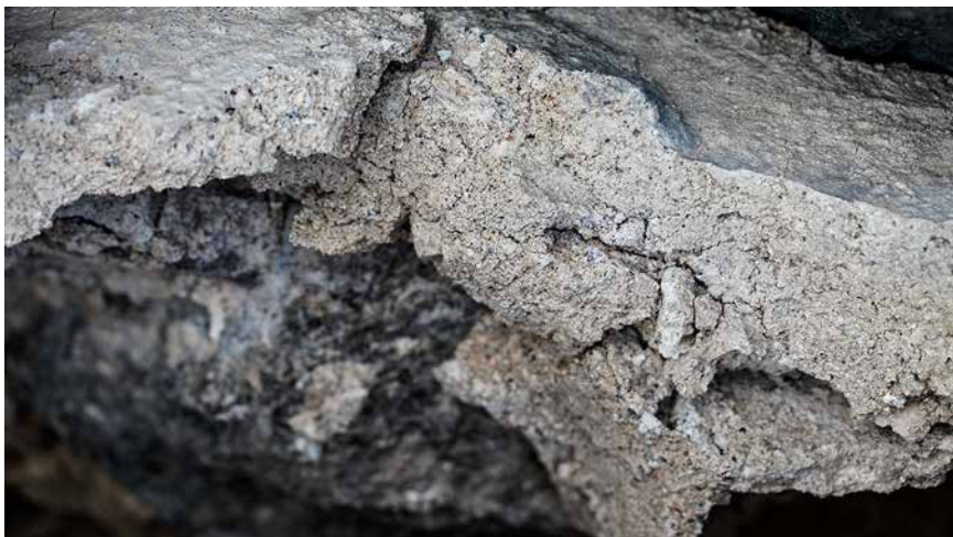
Överst i bild syns ovansidan på ett fyllningsskikt med välblandat, lättflytande bruk från murens övre halva. Både över och under brukskiktet finns hålrum.
