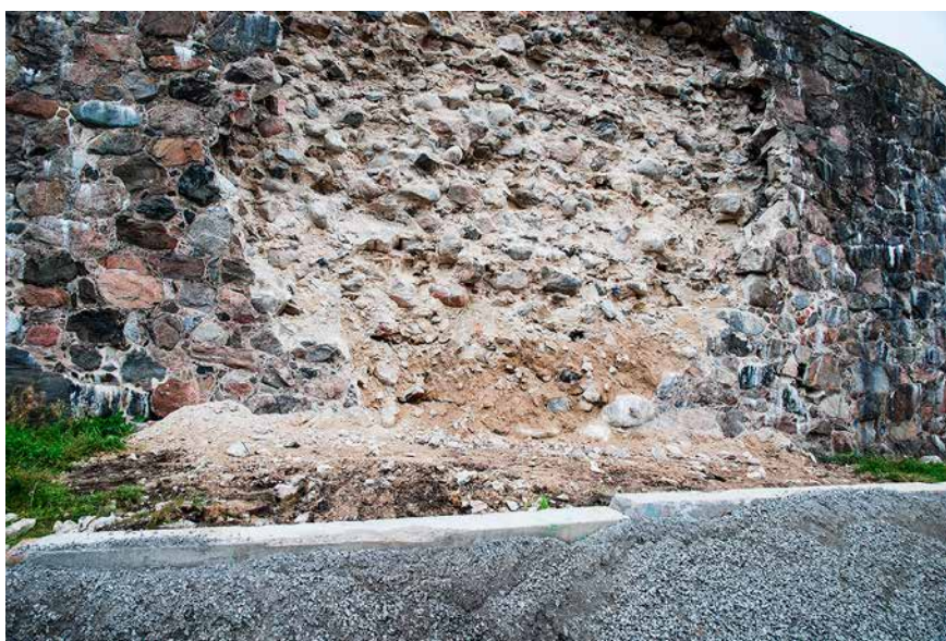
I förgrunden: skyddsbarriären fyra meter framför muren. Barriären är ungefär en halv meter hög och avsedd att stoppa stenar som faller eller petas ner från muren. Här har nerfallna skalstenar redan plockats bort, men rester av rasad kärna ligger kvar.
