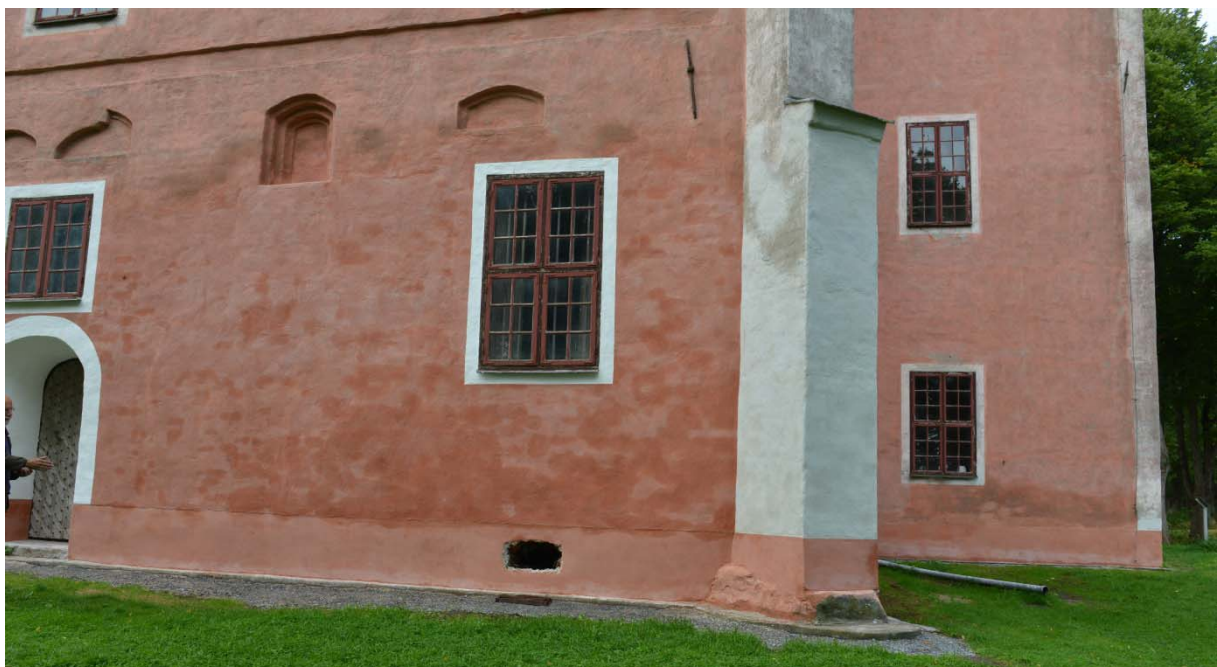
Efter offerputsning. Fuktbläckor efter regn.
