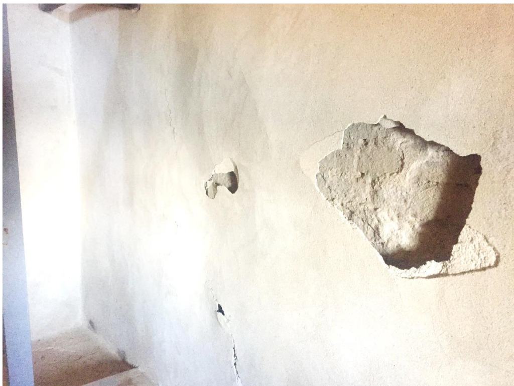
På första vilplanet finns en hel vägg där flera kvadratmeter puts släppt och buktar ut 5-10 cm från muren.
