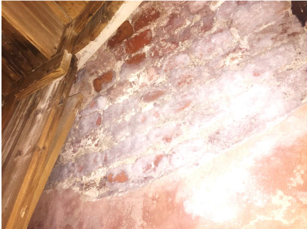
I utrymmet under trappan finns synligt salt och nerfallen puts.
