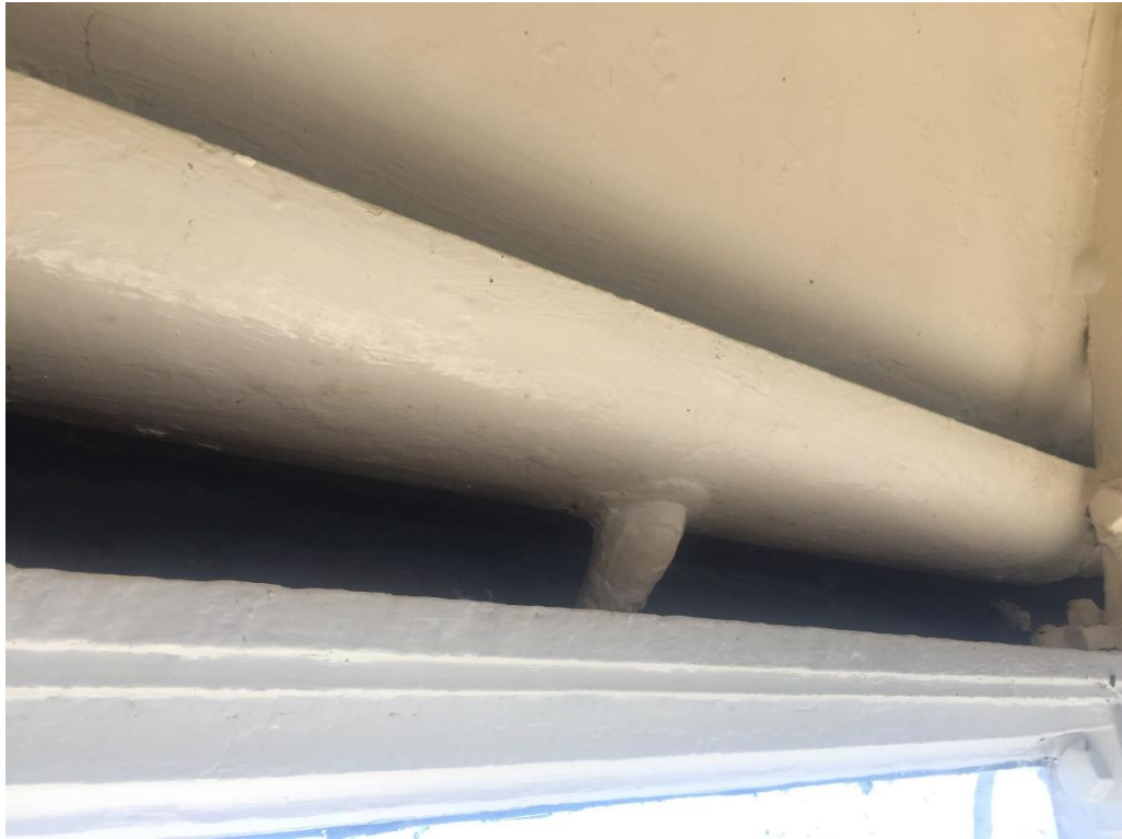
Dräneringshålen från övre rännan kan behöva rensas.
